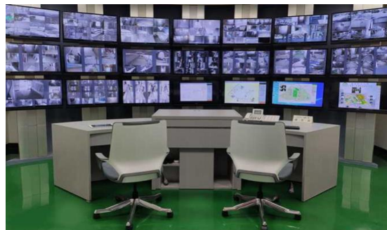
校園節約能資源暨安全防災監控中心
