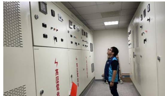
節能小組巡檢變電站
